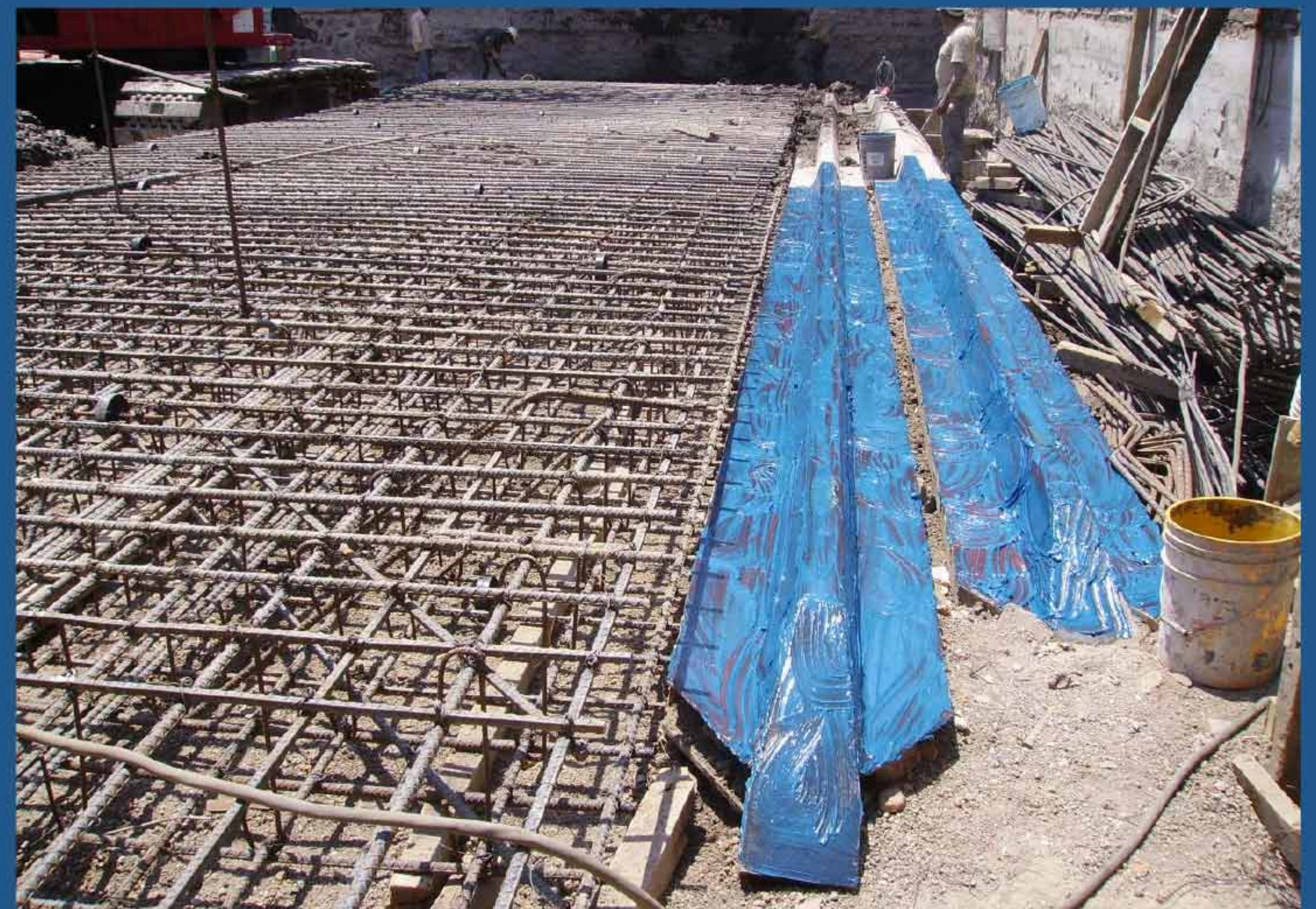
Vista de Juntas metálicas a utilizarse en Muro
